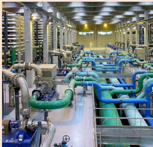
Imagen del interior de una planta desaladora.
