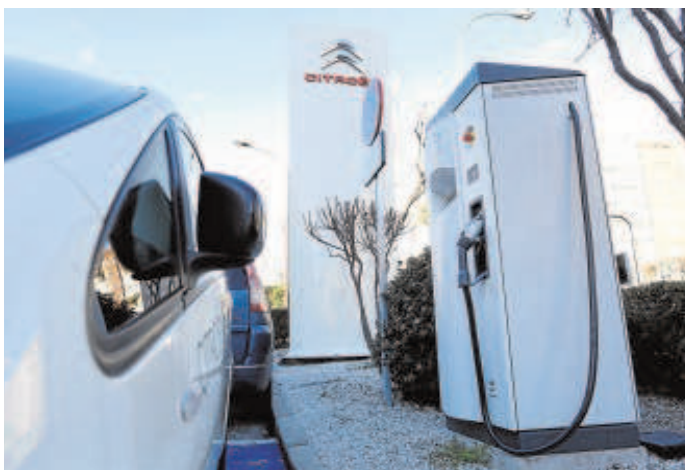
Punto de carga para coches eléctricos en Madrid
